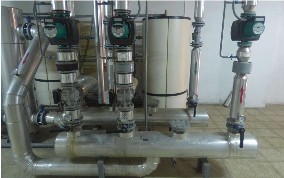
Figura 5.3.4: Fotografía de la distribución de circuitos y acumuladores de ACS
