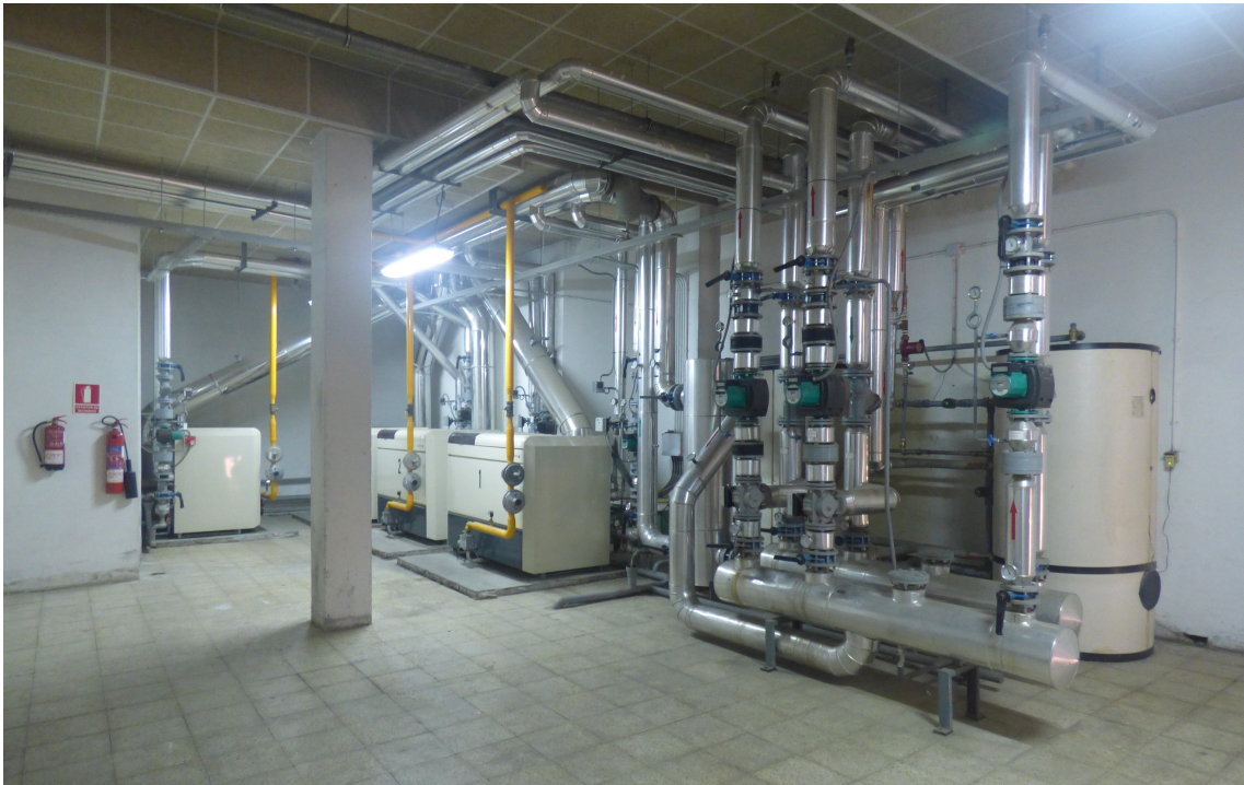
Figura 2.2.3: Vista general de la sala de calderas del sistema real
