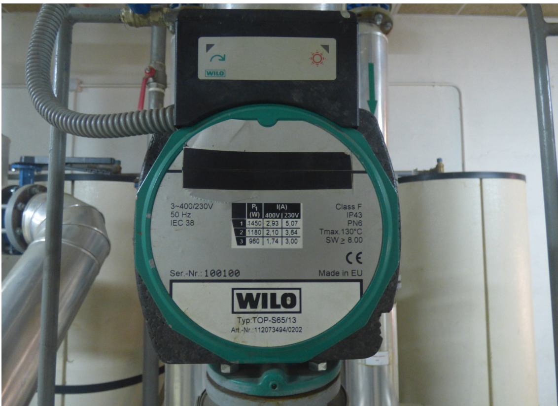
Figura 5.1.4: Fotografía de una de las bombas del sistema real
