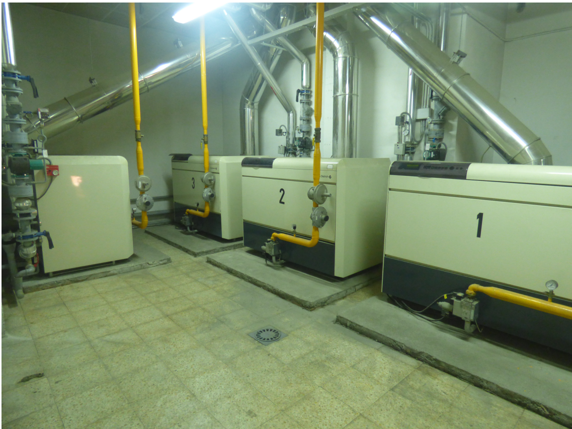
Figura 2.2.4: Fotografía de las cuatro calderas del sistema
