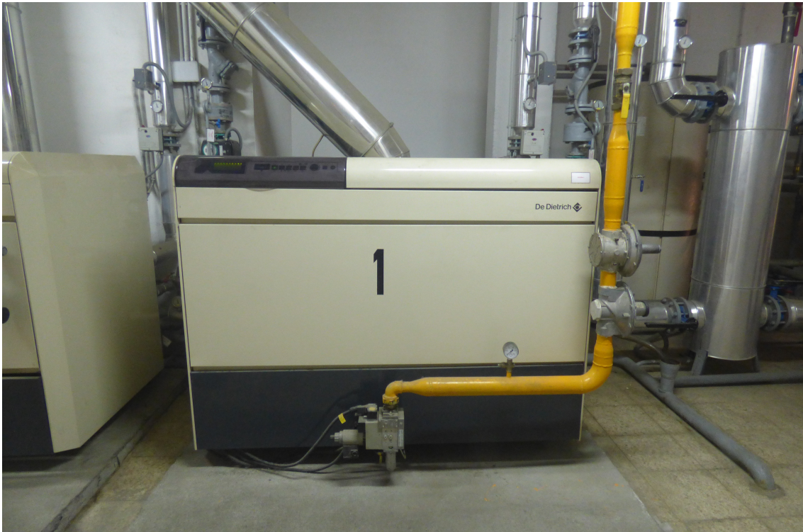
Figura 5.2.2: Fotografía de una de las calderas del sistema real
