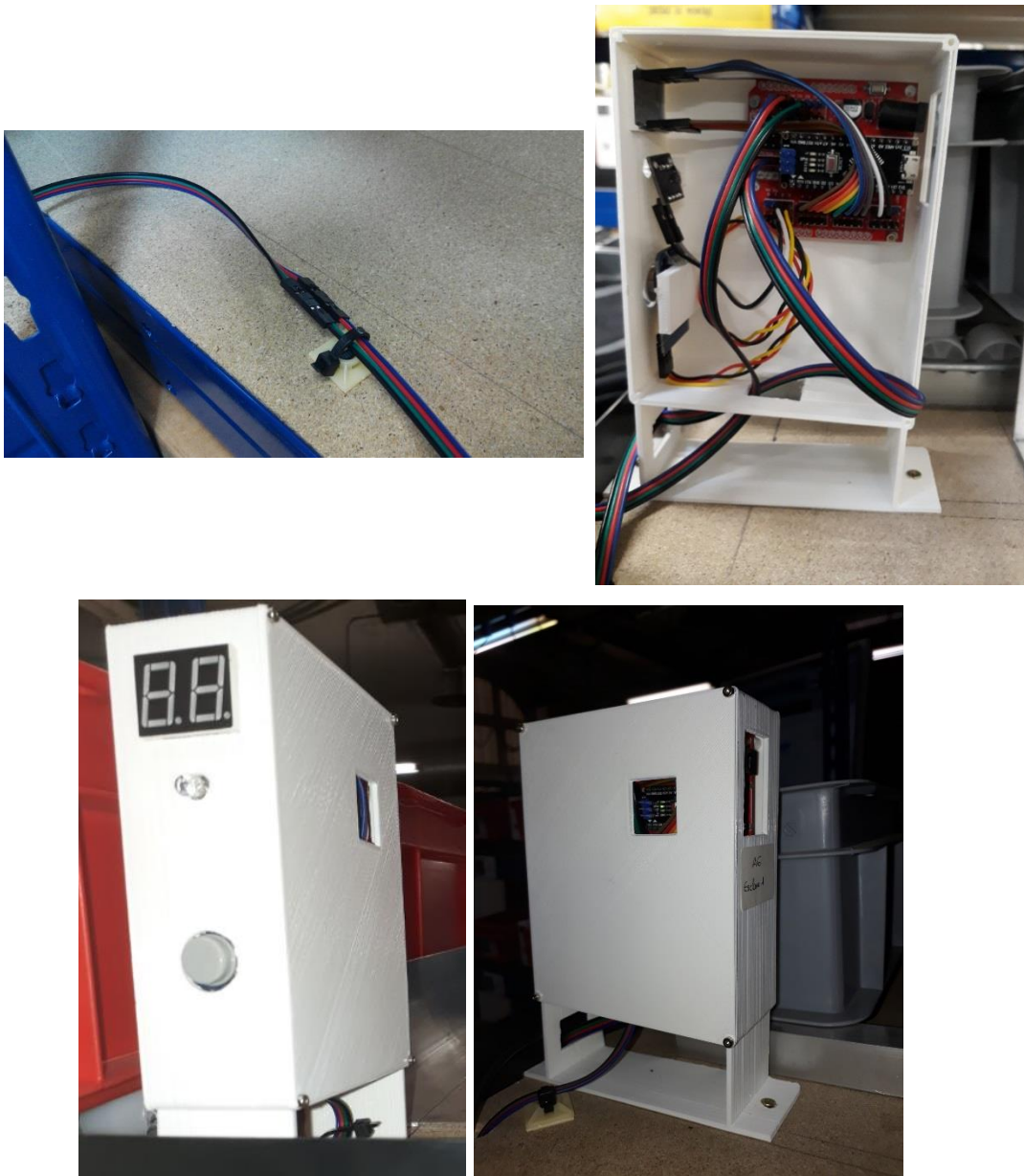
Figura 39: Detalle de los cables y las cajas.
