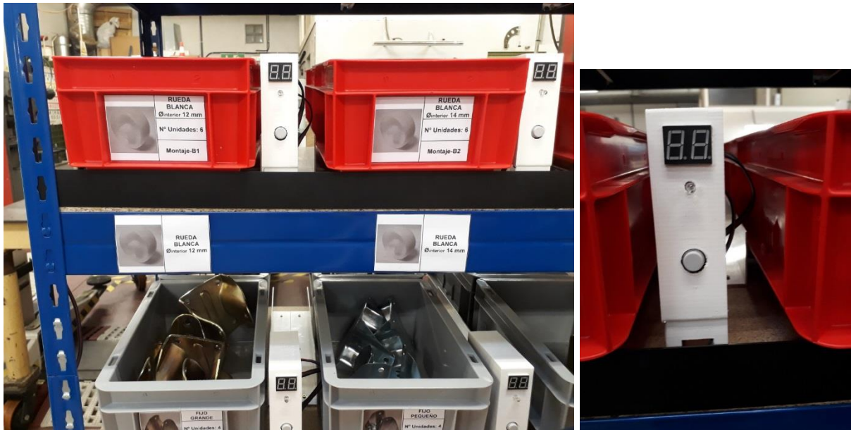
Figura 40: Detalles de la ubicación de los módulos de picking en la estructura.
