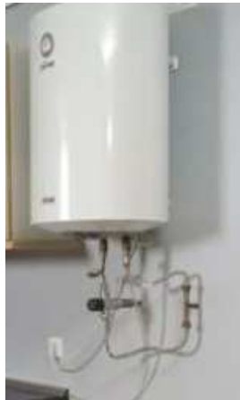
Imagen 22. Termo eléctrico de agua.
