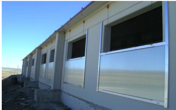
Imagen 17. Ventanas en cebo tipo guillotina con malla pajarera
