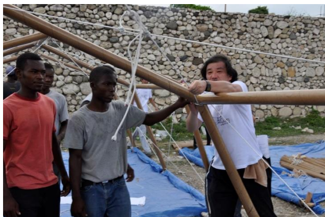
Fotografía 30. Refugio de emergencia. Shigeru Ban durante el proceso de instalación. Fuente: Imagen© Shigeru Ban Architects.
