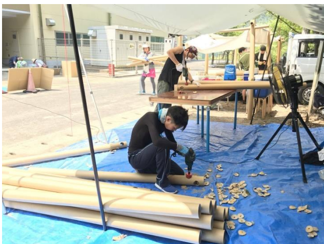
Fotografía 33. Refugio de emergencia. Preparación de las uniones in situ . Imagen @VoluntaryArchitectsNetwork (Facebook de la ONG de Shigeru Ban)
