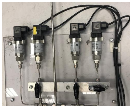
Fig 9. Sensores de presión con válvulas de cierre.
