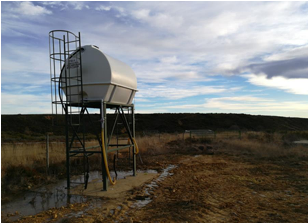
Figura 75. Punto de agua de baja capacidad de 8.000 l con estructura metálica y escalera. Fuente: Elaboración propia
