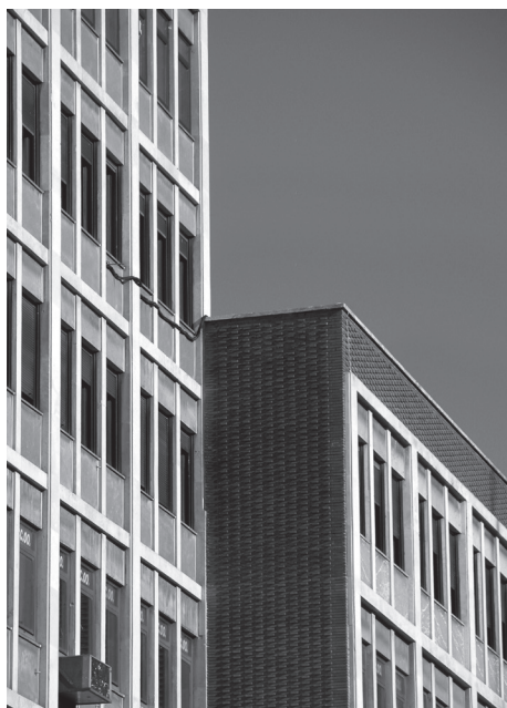
10 Julio González, Equipamientos y sede de Sindicatos . Valladolid (1959). Detalle de fachada [Foto: Iván Rincón Borrego]
