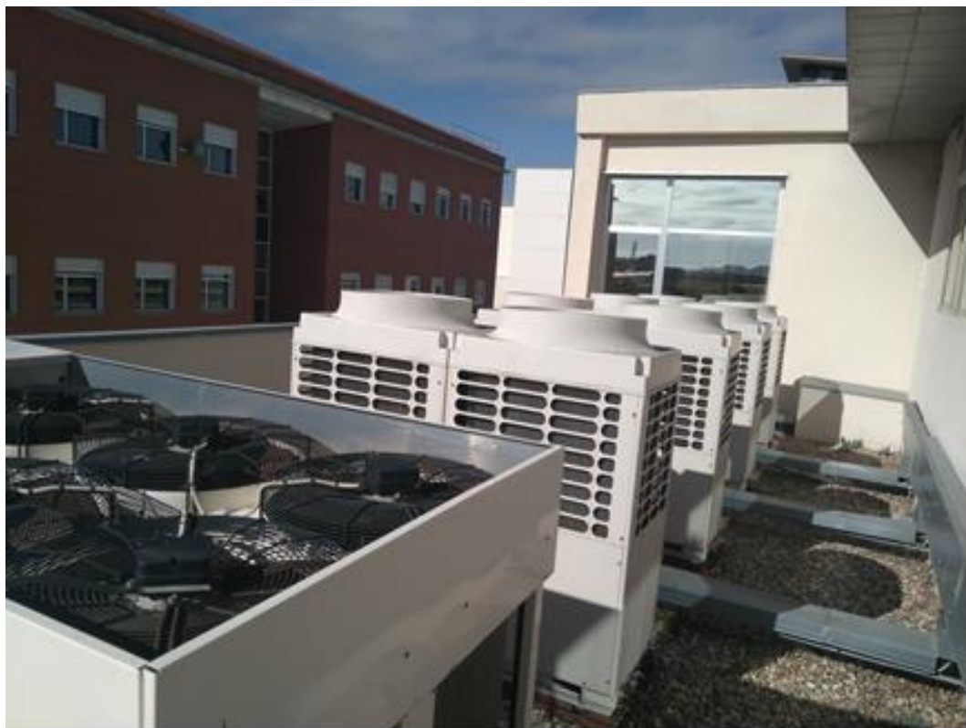
Ilustración 3.16. Bombas de Calor ubicadas en la terraza exterior del edificio.
