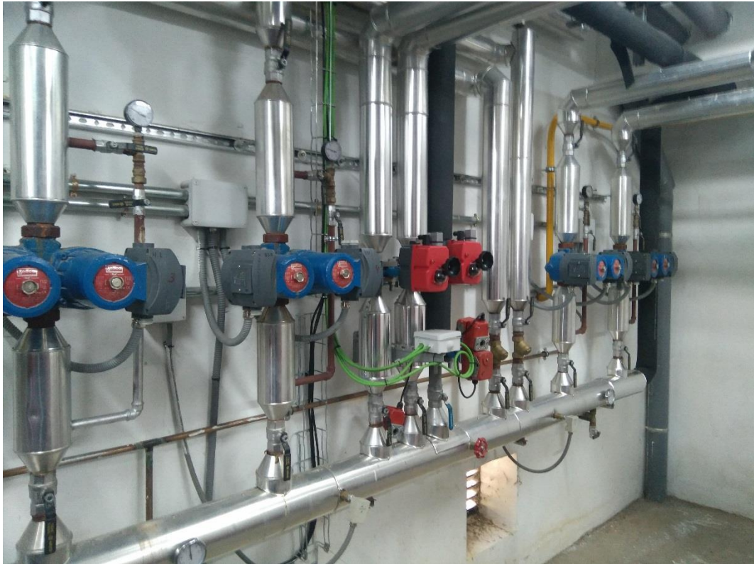
Ilustración 3.9. Grupo de bombeo en la sala de calderas.
