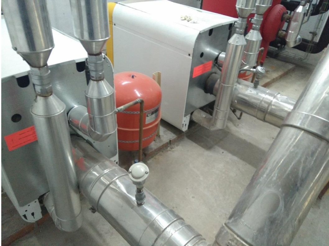
Ilustración 3.14. Calderas de gas natural de la sala de instalaciones.
