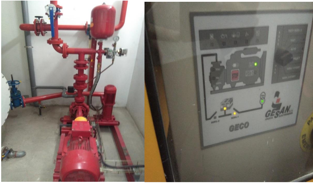
Ilustración 3.11. Grupo contra incendios (a la izquierda), y panel de control de grupo electrógeno (a la derecha)
