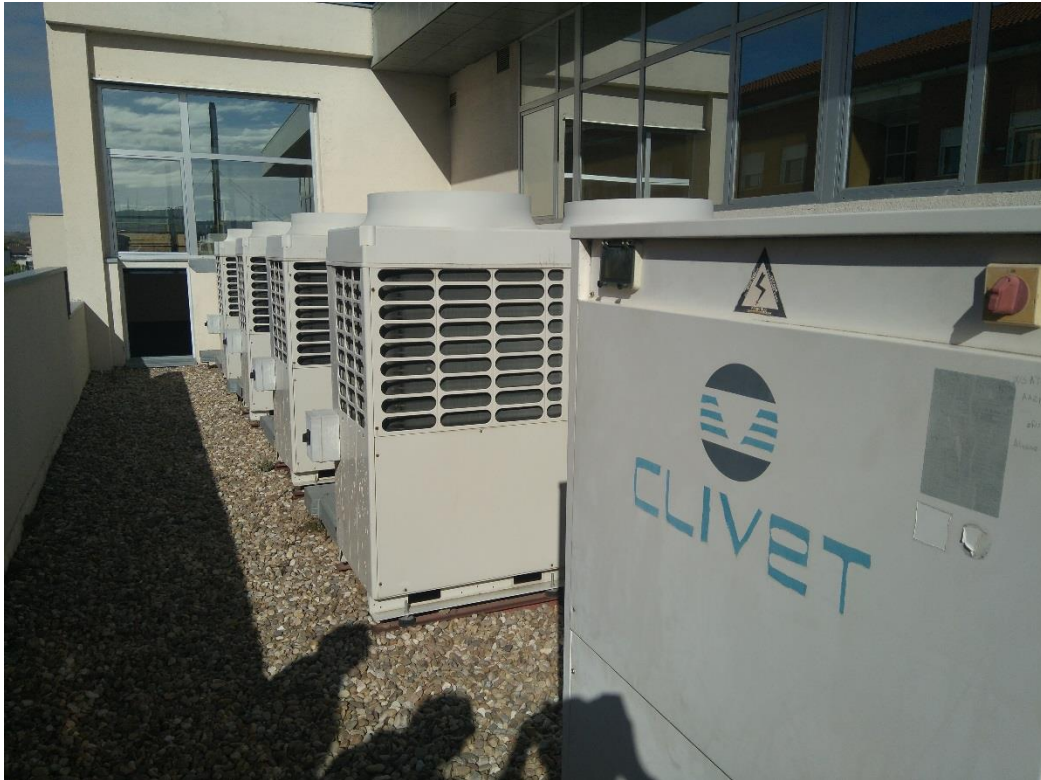
Ilustración 3.17. Bombas de Calor y Máquina de Frío Clivet en la terraza exterior.
