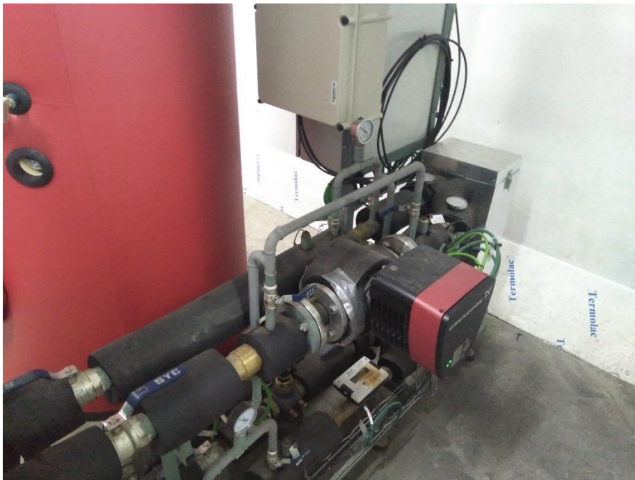
Ilustración 3.15. Intercambiador de placas y depósito de acumulación.
