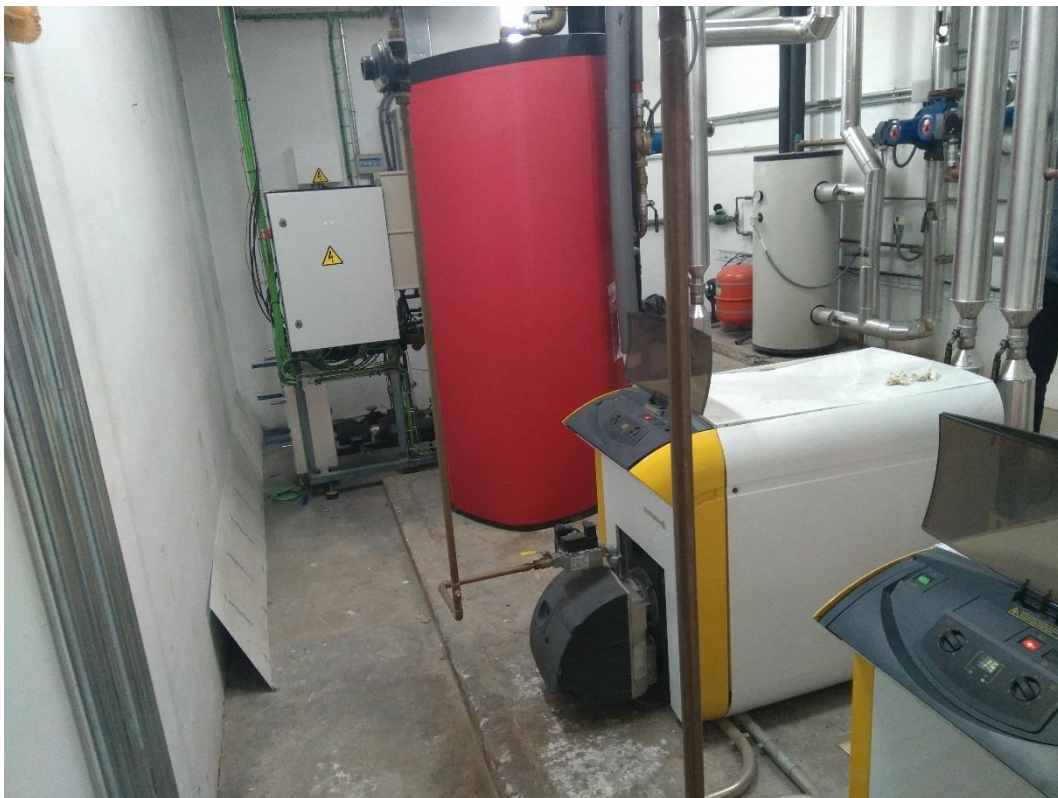
Ilustración 3.13. Calderas de gas natural en la sala de instalaciones.
