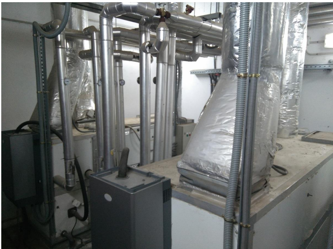
Ilustración 3.10. Climatizador y humectador que dan servicio a quirófanos en planta sótano.
