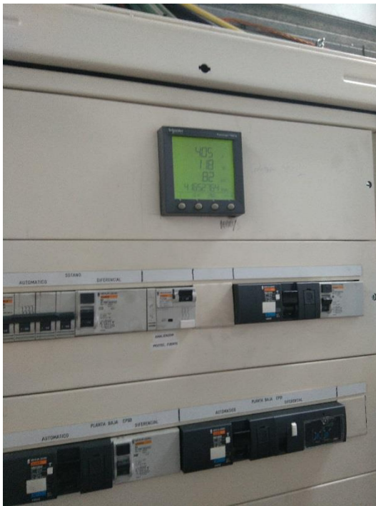
Ilustración 6.4. Cuadro eléctrico del IOBA.
