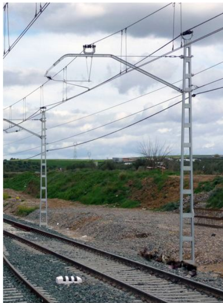
Figura 3.24. Catenaria con ménsula en celosía
