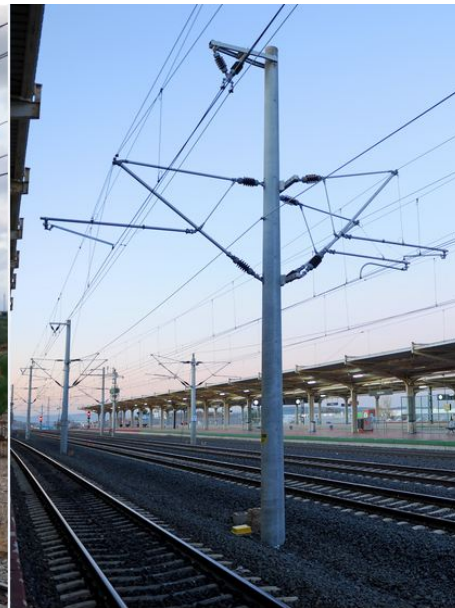
Figura 3.25. Catenaria con ménsula tubular
