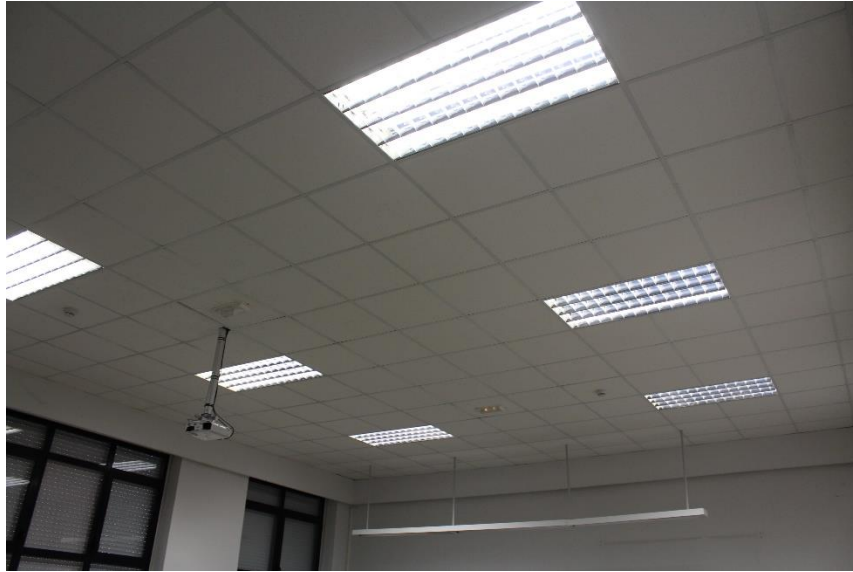
Fig. 29. Posición 2: Sólo las luminarias del techo (A Y B). Fuente: Elaboración propia.
