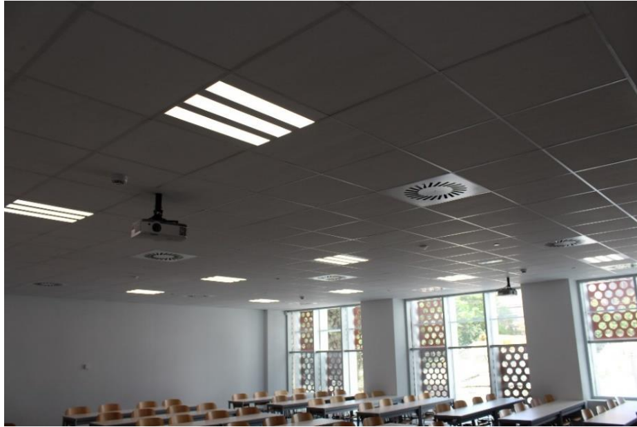
Fig. 15. Posición 4: Solo las luminarias del techo (A y B). Fuente: Elaboración propia.
