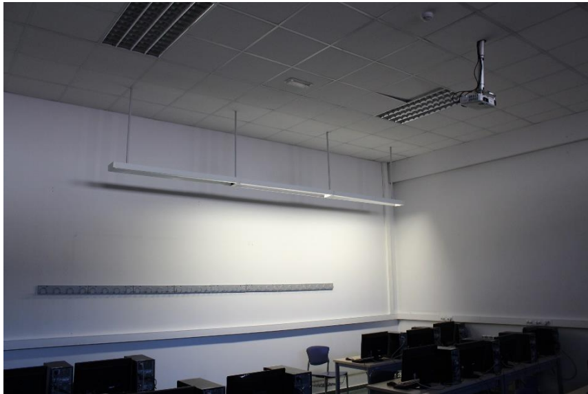
Fig. 23. Posición 3: Solo la luminaria del final (sin las del techo). Fuente: Elaboración propia.
