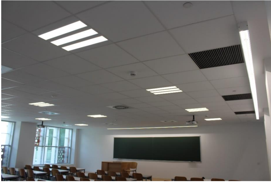
Fig. 13. Posición 2: Todas las luminarias encendidas. Fuente: Elaboración propia.
