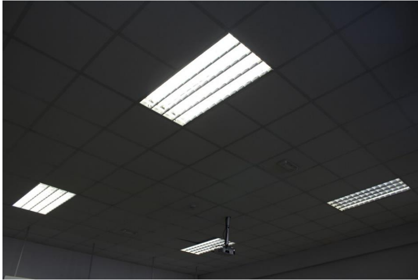
Fig. 22. Posición 2: Sólo las luminarias del techo. Fuente: Elaboración propia.
