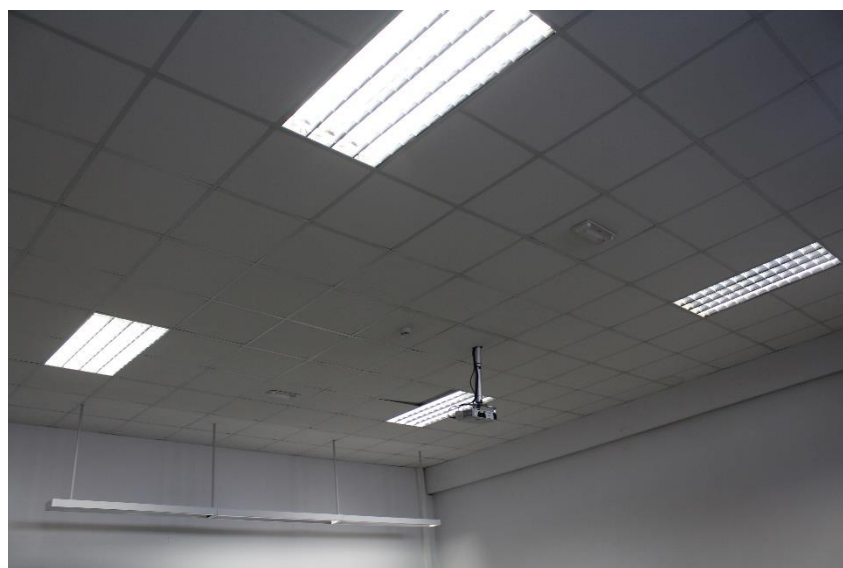
Fig. 21. Posición 1: Todas las luminarias encendidas. Fuente: Elaboración propia.
