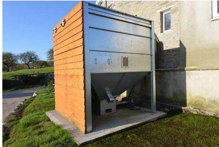
Figura E.1 Tolva exterior. Fuente: Silotec.
