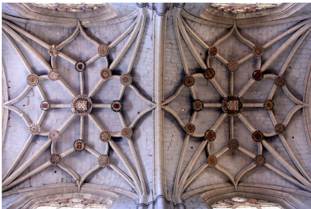
Fig. 147. Bóvedas de los dos últimos tramos de la nave central. Pascual de Jaén. 1515-1516. Catedral de Palencia.
