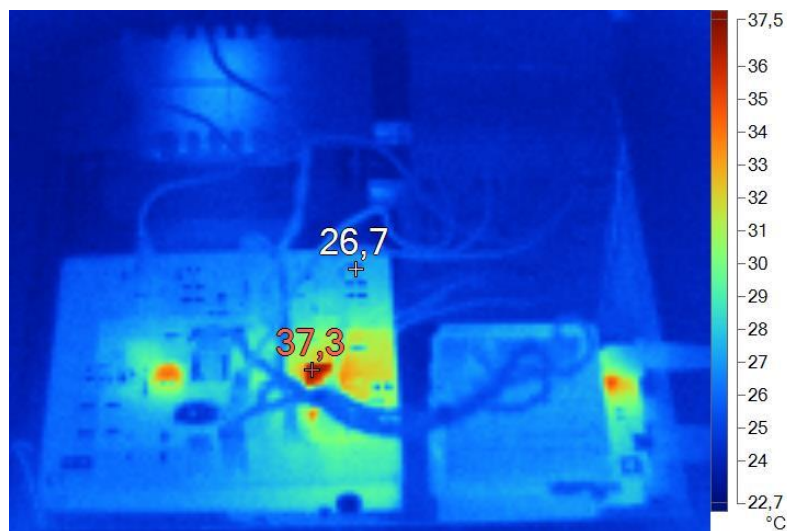
Ilustración 67. Imagen térmica I.
