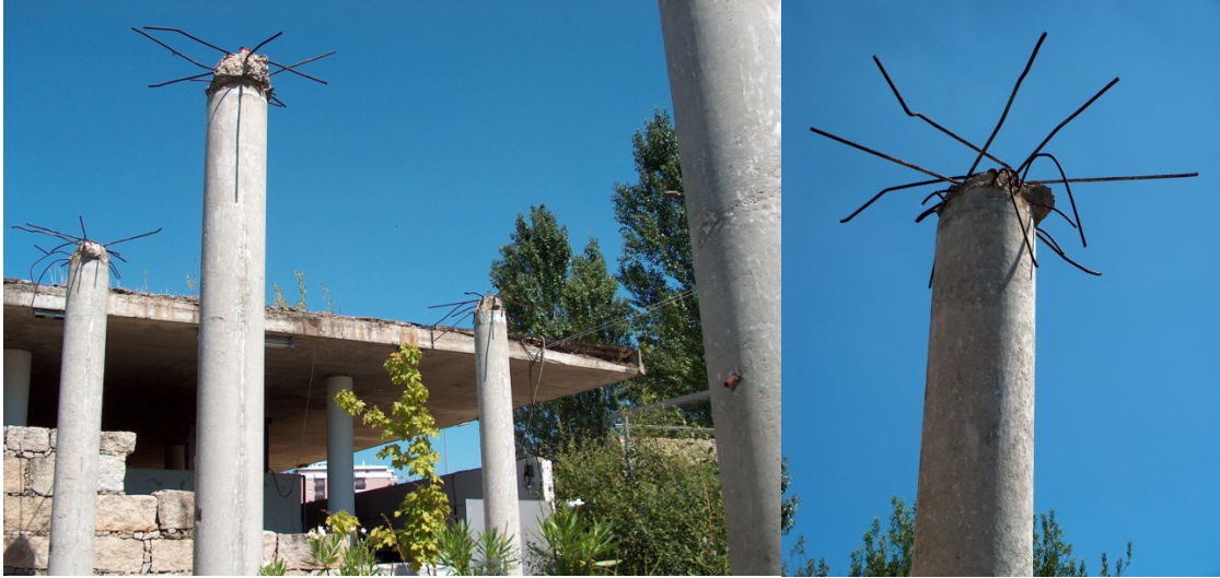
fig. 40 – Imagem dos pilares da cobertura do Mercado de Braga após a sua remodelação
