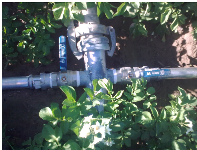
Figura 7: Montaje de las cruces a las tuberías secundarias, a las válvulas de esfera o bola, a los acoples hembra macho y a las tuberías secundarias
