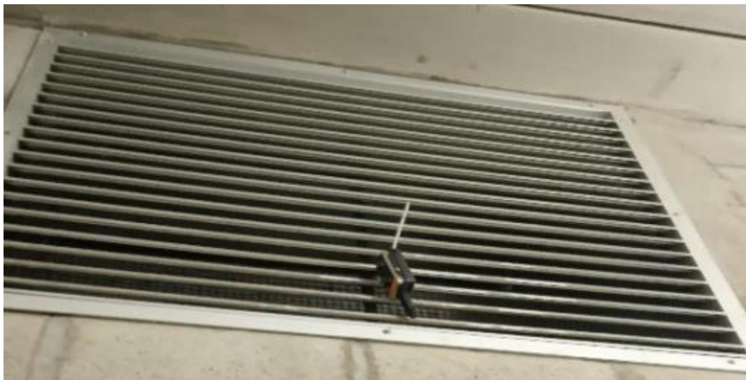
Figura 8. Sonda de temperatura colocada a la salida del intercambiador del edificio LUCIA [35].
