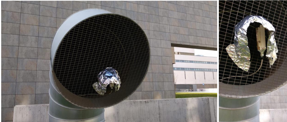
Figura 7. Sonda de temperatura colocada a la entrada del intercambiador del edificio LUCIA.
