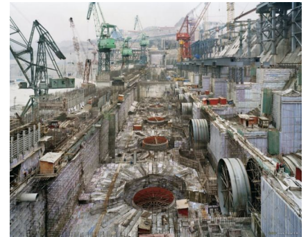
Fig.2. Presa de las Tres Gargantas situada en el curso del río Yangtsé en China.
