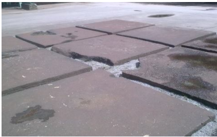
Fig. 4.1. Plaza Metálica del parque de Duisbrüg-Nord. Compuesta por placas de acero de la antigua fosa de fundición que hoy en día recrean un punto de encuentro y reunión. En la foto se muestra la erosión de estas piezas con el paso del tiempo.
