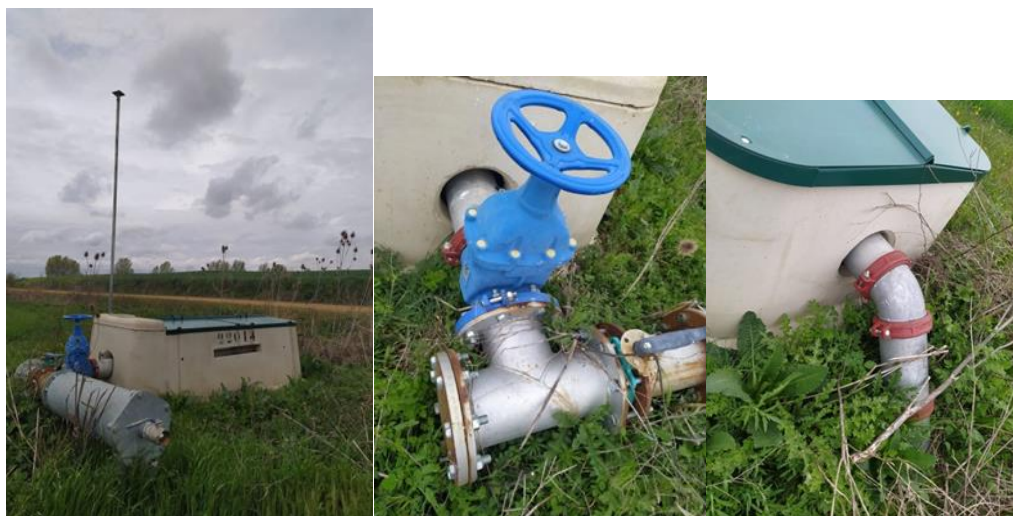
Ilustración 3: Toma de agua y punto hidrante de la explotación.
