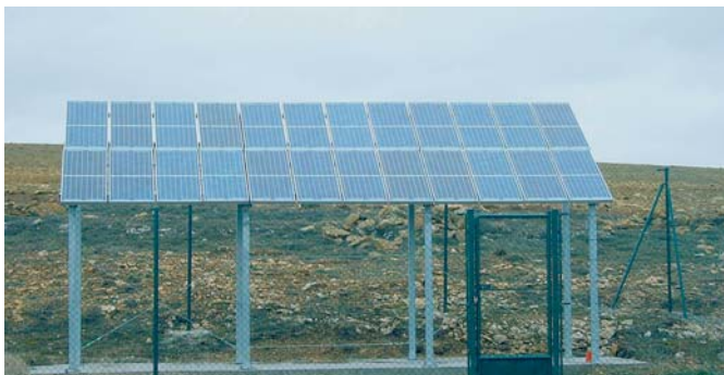
Instalación fotovoltaica aislada para riego
