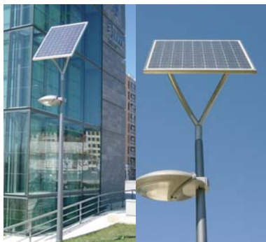
energia solar fotovoltaica
