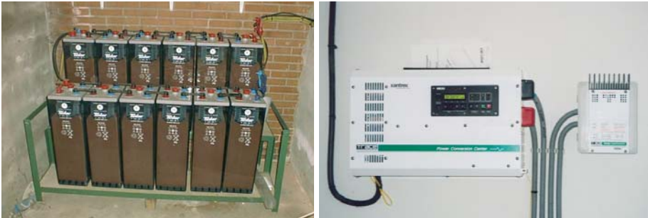
Acumuladores eléctricos y equipos electrónicos de una instalación fotovoltaica aislada
