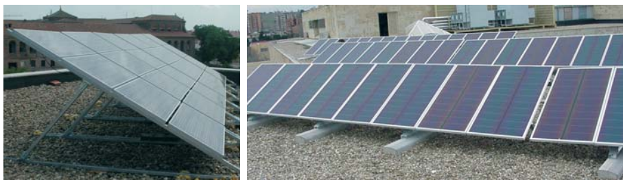
Instalaciones solares fotovoltaicas conectadas a red
