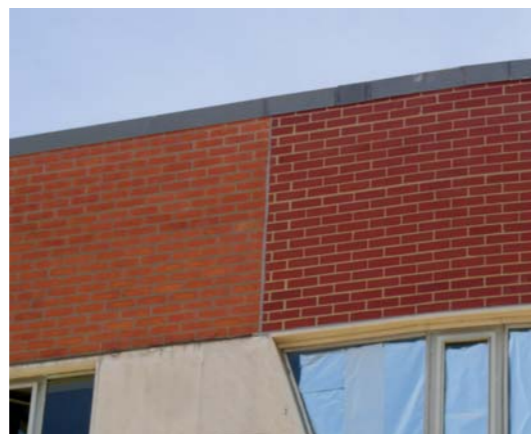
Fig. 3.54: SOUTINHO, Alcino – Departamento de Engenharia Cerâmica e do Vidro , 1987/92. Os dois tipos de tijolo denunciam as reparações efetuadas na fachada do edifício.
