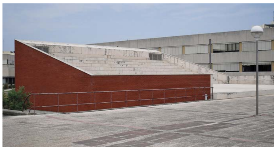
Fig. 4.42: PORTAS, Nuno; OLIVEIRA, Joaquim – Ampliação da Zona Técnica Central: Livraria, Sala de Leitura e Centro Multimédia , 1996/99. Vista da cobertura em anfiteatro.
