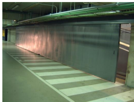
Figura 16. Puerta cortafuego corredera
