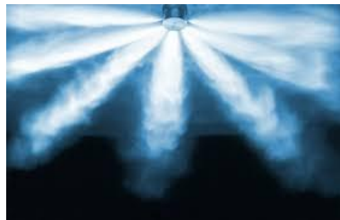
Figura 39.- Sistema de Agua Pulverizada
