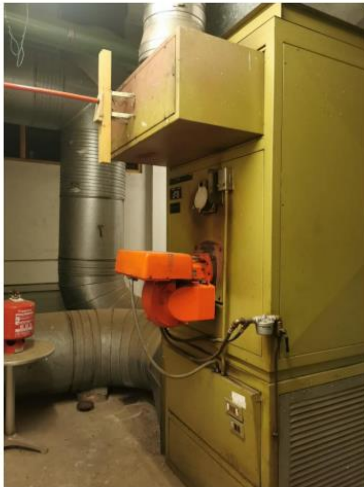
Figura 6: fotografía de las actuales calderas de gasóleo (polideportivo) Fuente: elaboración propia
