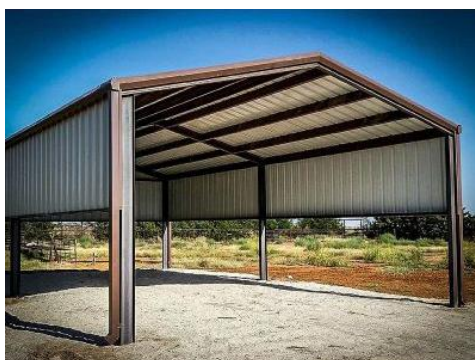
Figura 13: almacén exterior de biomasa cubierto
