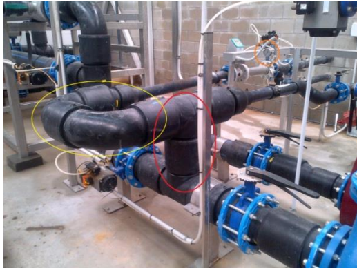
Figura 1: Situación inicial de las tuberías
