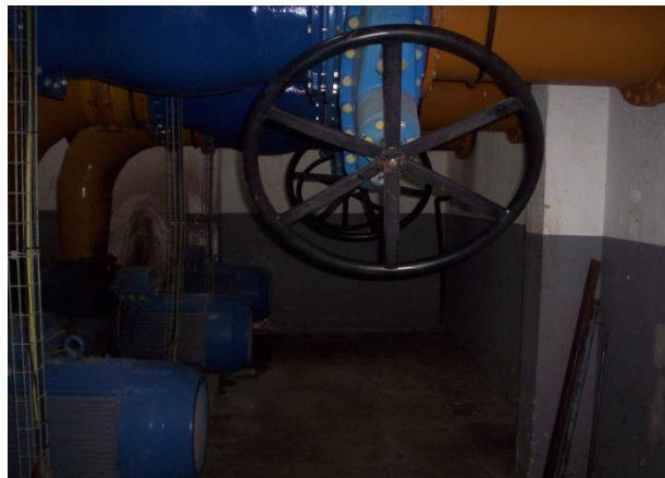
Fotografía 8: Sala de bombas de recirculación de fangos.
