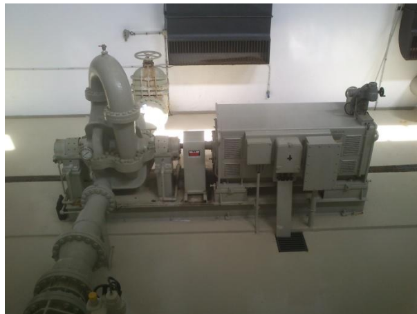
Fotografía 6: Bomba de impulsión (1.000CV) situadas en las instalaciones de BALTEN.
