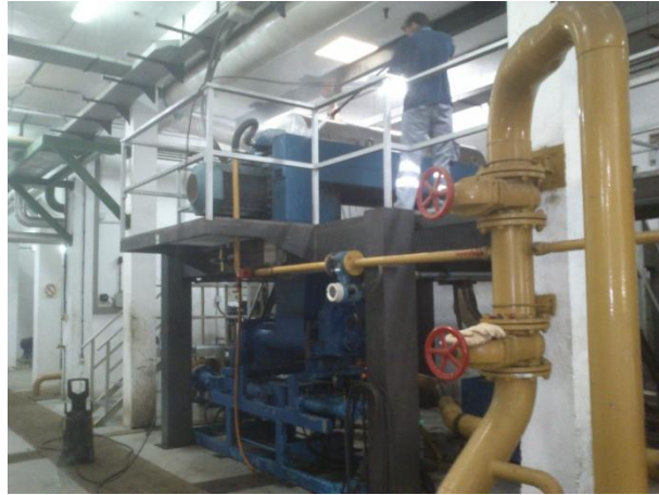
Fotografía 4: Centrifugadora de fangos.
