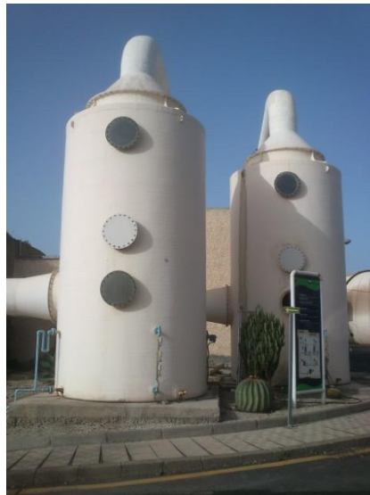
Fotografía 5: Sistema de desodorización.
