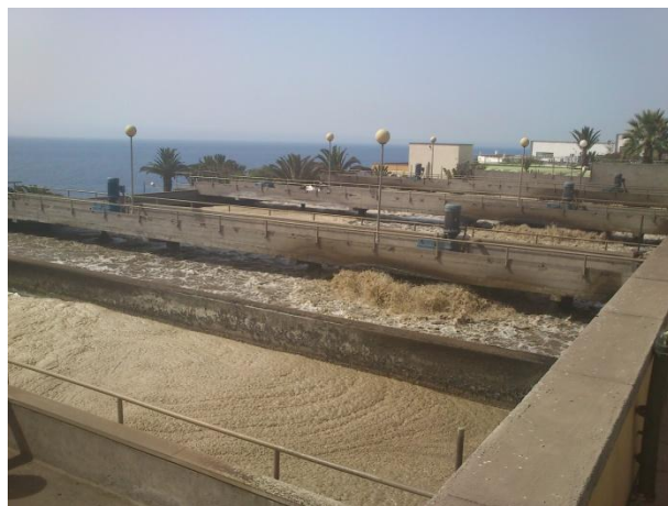
Fotografía 2: Cubas de aireación.
