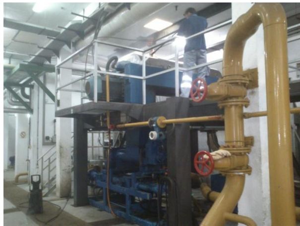
Fotografía 12: Centrifugadora de fangos.
