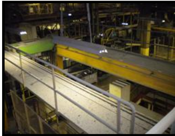
Ilustración 18. Puente grúa. (Fuente: Michelin)
