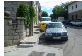
Acera escalonada, obliga a los usuarios de silla de ruedas a circular por la calzada.
