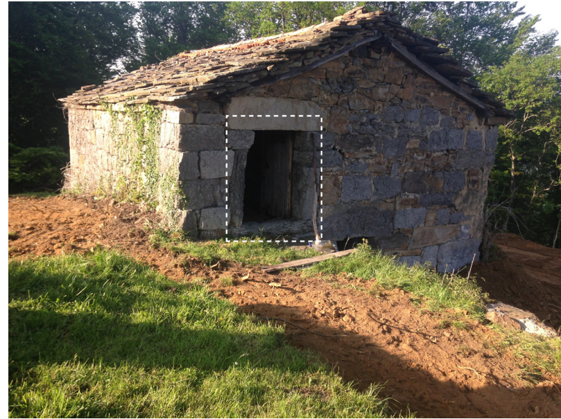
Patología en puerta de entrada - piedra descascarillada
