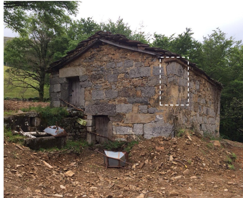
Patología en esquina - grieta por sobrecarga
