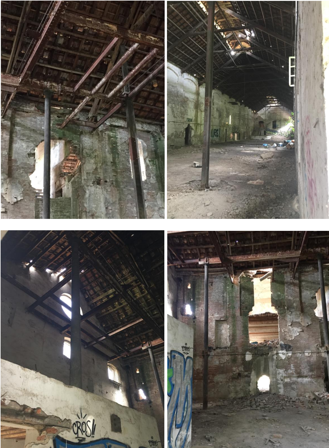
Figura 42. Fotografías del interior de la azucarera de Nuestro Señor de la Salud
