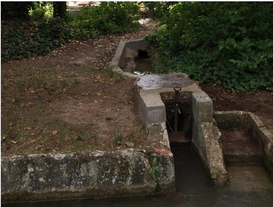
Figura 46. Fotografía de una compuerta de riego en la Acequia de Laguna.
