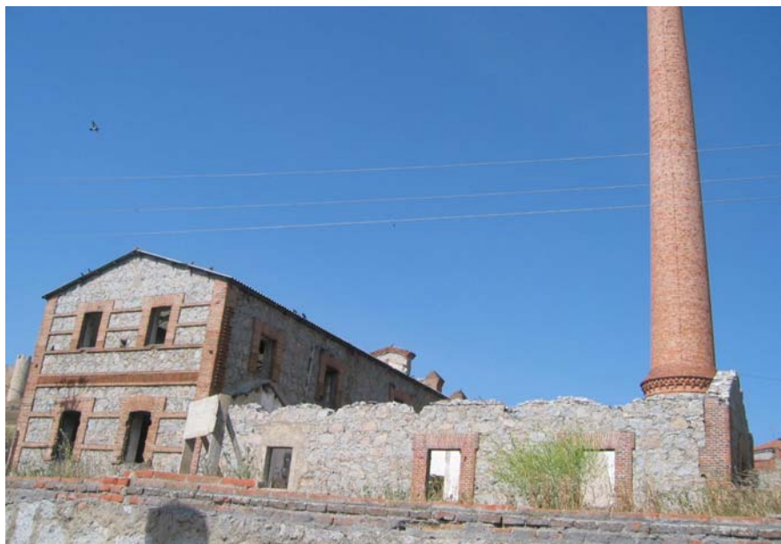
Fig. 2: Edificio en ruinas de la fábrica de luz y harinas de Ávila. Archivo de los autores, 2006.
