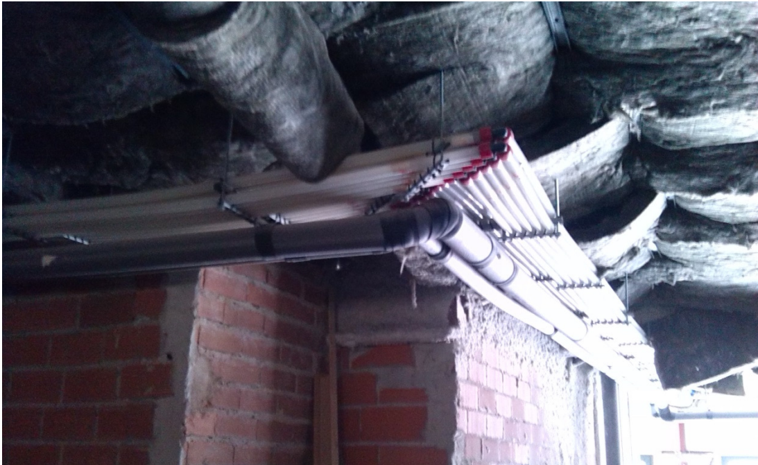
Figura 7. 14_ Lana de roca expuesta, falso techo sin placa yeso laminado instalada.
