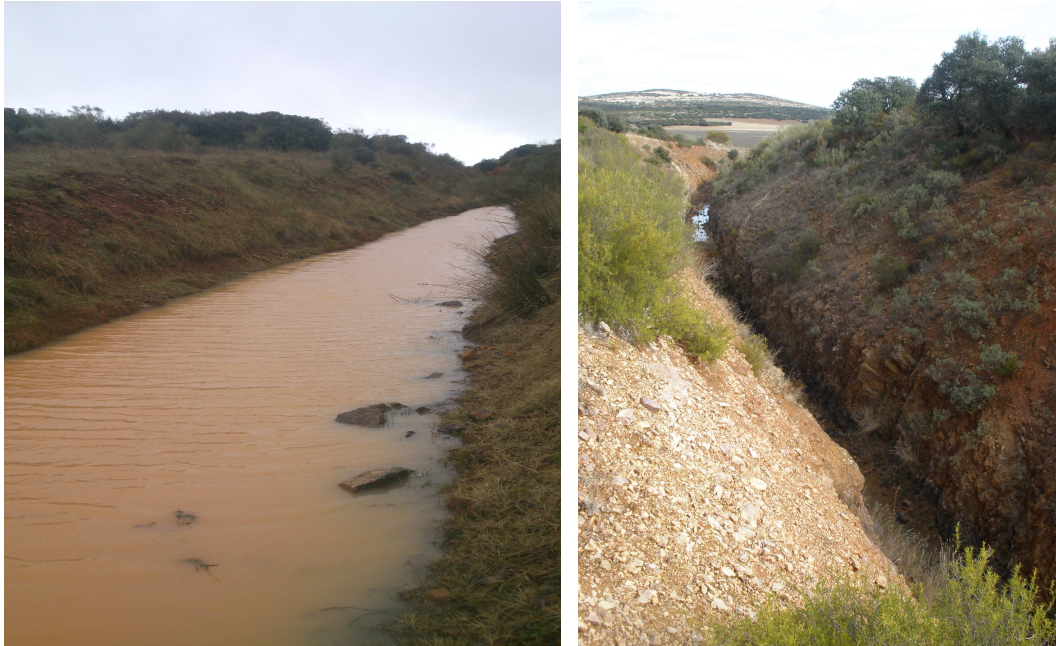
Imagen 1.6. El drenaje longitudinal inundado (14/01/2014) Imagen 1.7. El drenaje longitudinal el 10/11/2013
