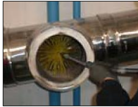
Figura 5.10 Limpieza de cenizas de la chimenea.
