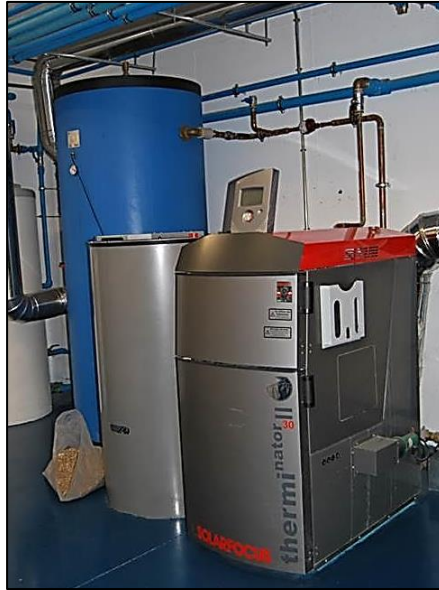
Figura 5.6 Caldera, depósito de inercia y depósito de alimentación.
