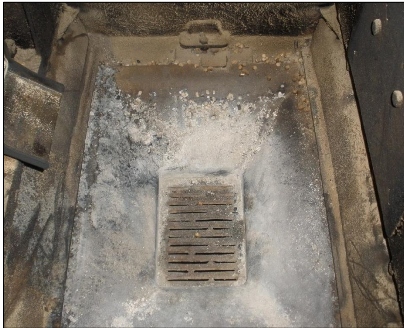
Figura 7.10 Situación de la cámara de combustión finalizado el ensayo de la muestra 8.
