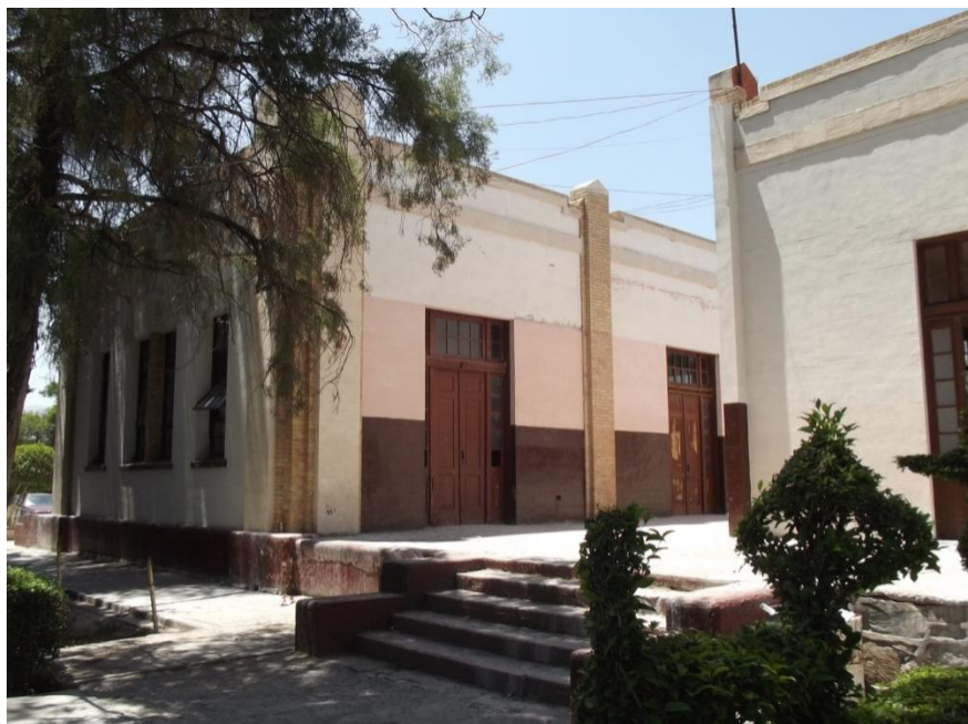
Salón de la parte final de las aulas traseras. Éste corresponde al que mira hacia el sur.
