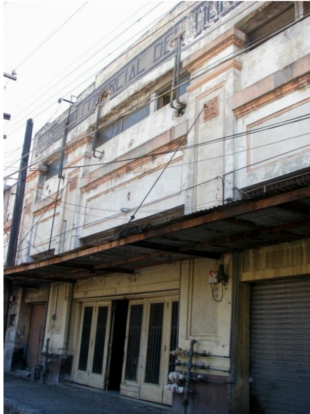
Acceso por la fachada norte en la calle Díez Gutierrez. Las tuberías y el cableado la han invadido por completo.
