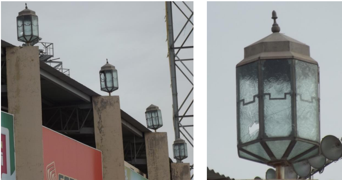
Lámparas originales y el detalle de una de ellas donde se nota el deterioro.
