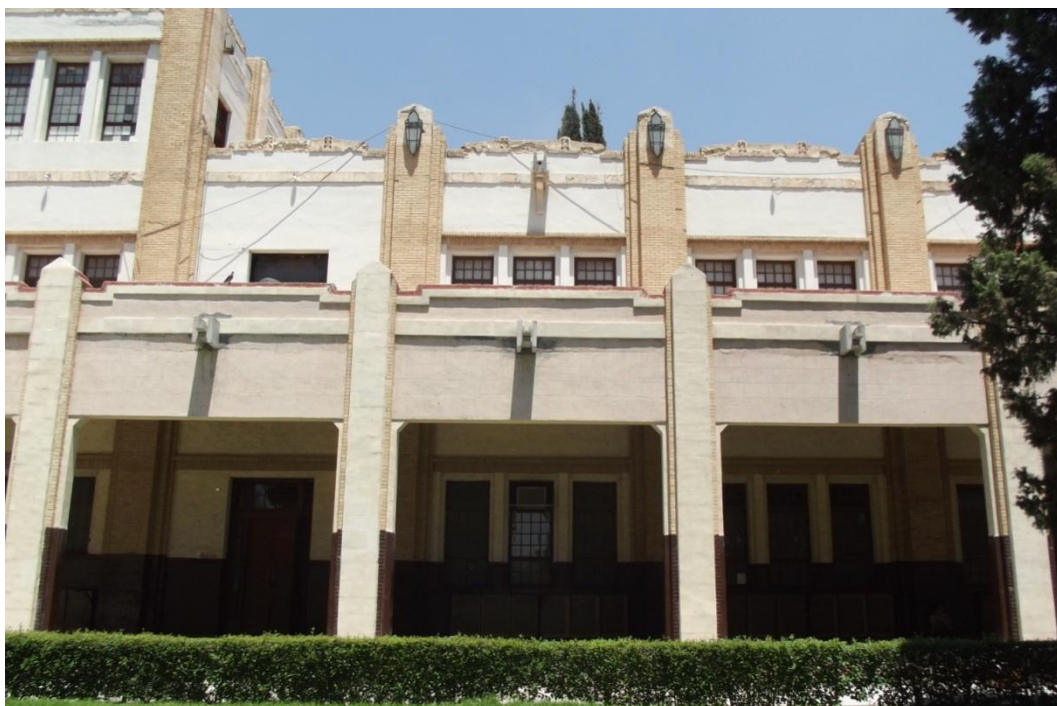
Corredor y aulas de la parte trasera adosada al cuerpo central. Se aprecia la moldura horizontal, los botaguas cúbicos y las pilastras del muro que se prolonga hacia el segundo piso. Los ábacos de segundo nivel están bastante deteriorados.
