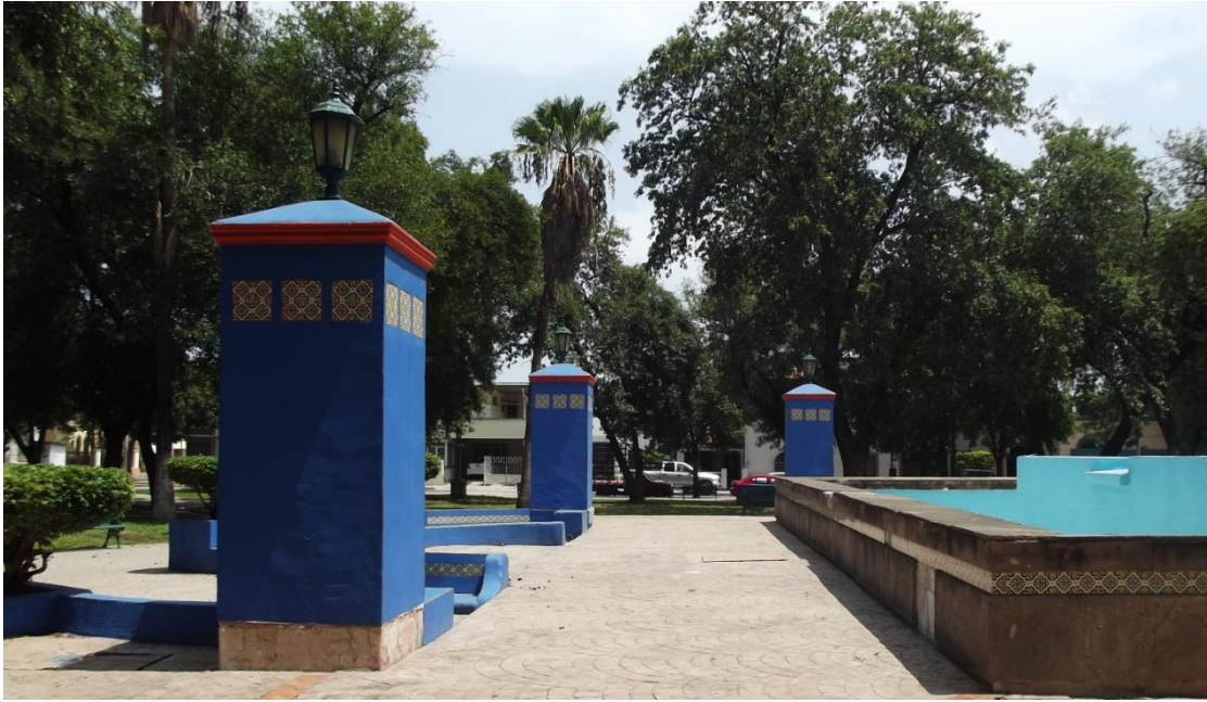
Tres de los pilares en sus condiciones actuales.
