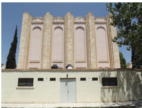
Muro trasero del escenario con el agregado de 1967 que estropeó la visibilidad.
