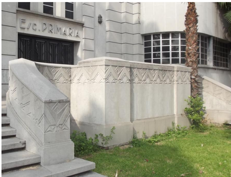
Detalle de la decoración tipo zigzag en el pasamanos de la escalera y en el pretil.
