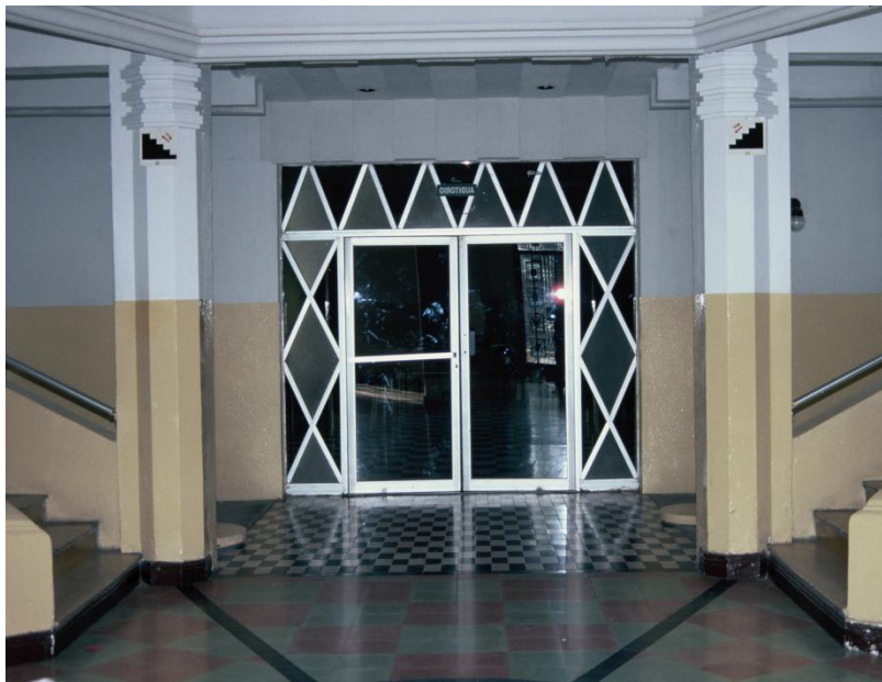
Vestíbulo. Se aprecian los anillos que forman el capitel de las columnas, las traveses con sus molduras, los pasamanos de la escalera y las figuras geométricas del piso y de la puerta del auditorio.
