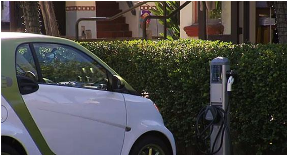
Figura 3.4.: Cargador de vehículos eléctricos en aparcamientos
