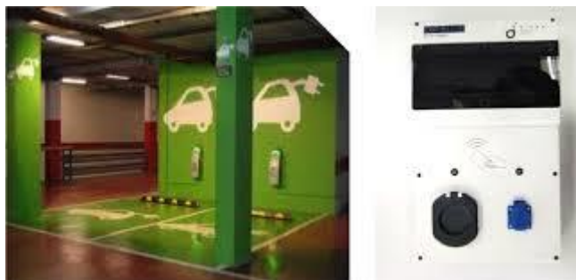
Figura 3.5.: Espacio habilitado en aparcamiento subterráneo para la carga de vehículos eléctricos
