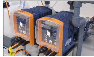
Ilustración 9. Bombas P3, P4
