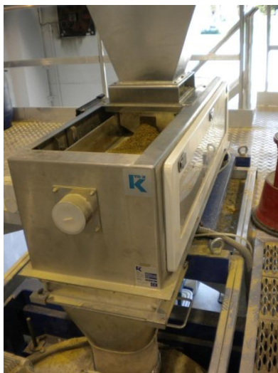
Figura 2.5- Dosificador gravimétrico del extrusor HT53.
