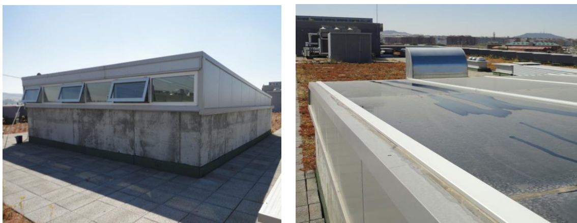
FIGURA 69. Lucernario norte. Izquierda: estructura del lucernario apoyado sobre un murete de hormigón visto. Sistema automático de apertura para ventilación. Derecha: superior del lucernario con el vidrio fotovoltaico sucio. Imágenes propias.
