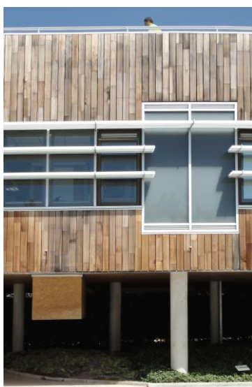
FIGURA 13. Lucernaire y captador solar integrados en la fachada. Explicación de funcionamiento en invierno y en verano. Imagen propia tomada el 24 de julio a las 13:00.
