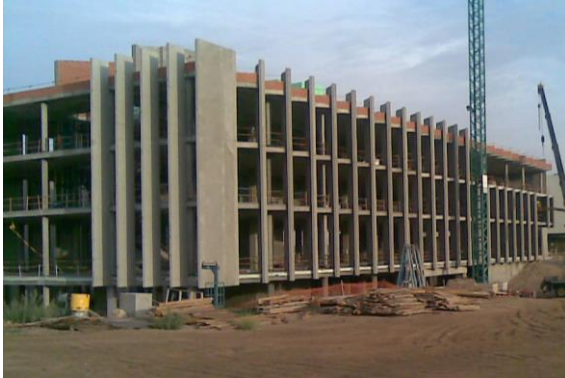
FIGURA 55. Imagen de obra. Colocación de los paneles prefabricados de hormigón. Foto cedida por la Unidad Técnica de la Universidad de Valladolid.
