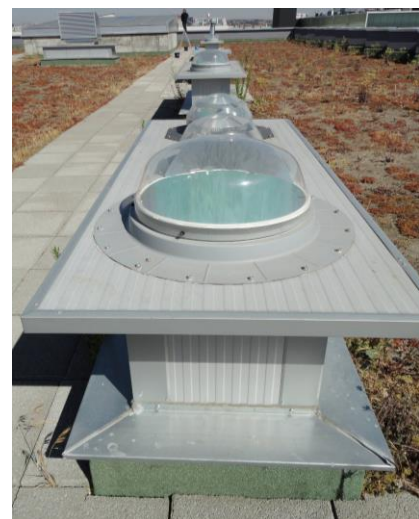
FIGURA 62. Módulo en cubierta. Incorpora dos pequeños y uno grande. Imagen propia.
