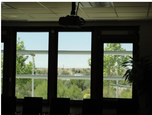
FIGURA 26. Huecos de la fachada principal con la rejilla automática de ventilación. Imagen propia.
