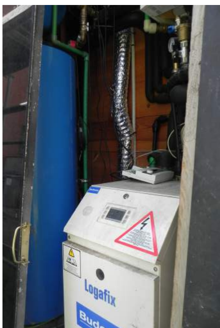
Figura 2.4. Bomba de calor en mochila técnica. (Imagen actual)
