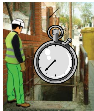
Acceso a CT subterráneo.
