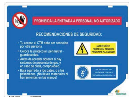
Señal de acceso a CT subterráneo.
