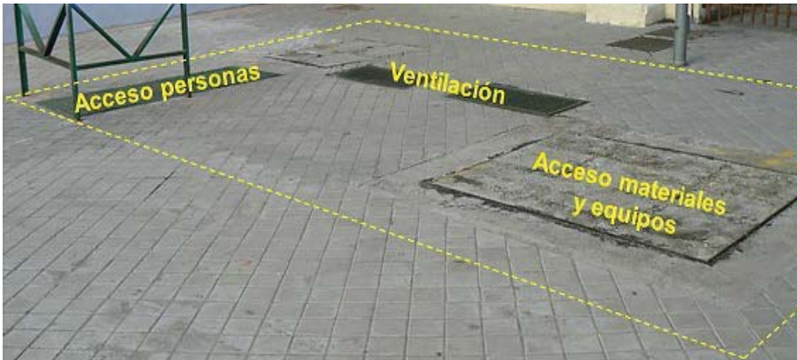
Aberturas de un CT subterráneo.
