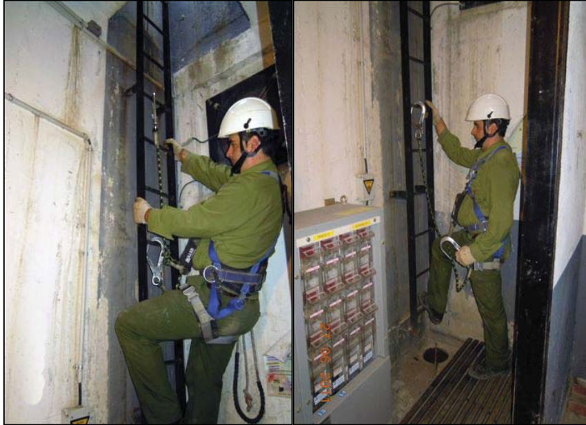
Acceso a CT subterráneo.
