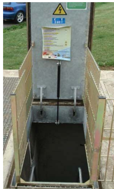
Acceso al Centro de Transformación.
