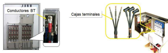
Cables de BT y botellas terminales.
