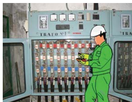
Verificación de ausencia de tensión en CBT.
