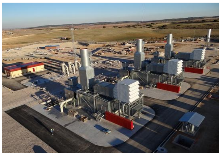
Estación de Compresión
