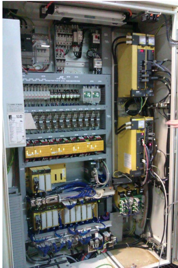
Figura 48: Armario eléctrico máquina Grob
