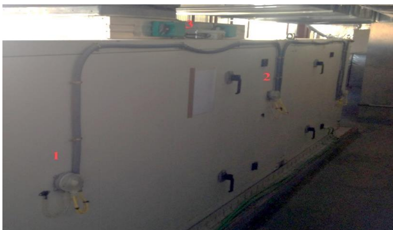
Figura 19. Sondas de presión diferencial in situ (1 y 2)
