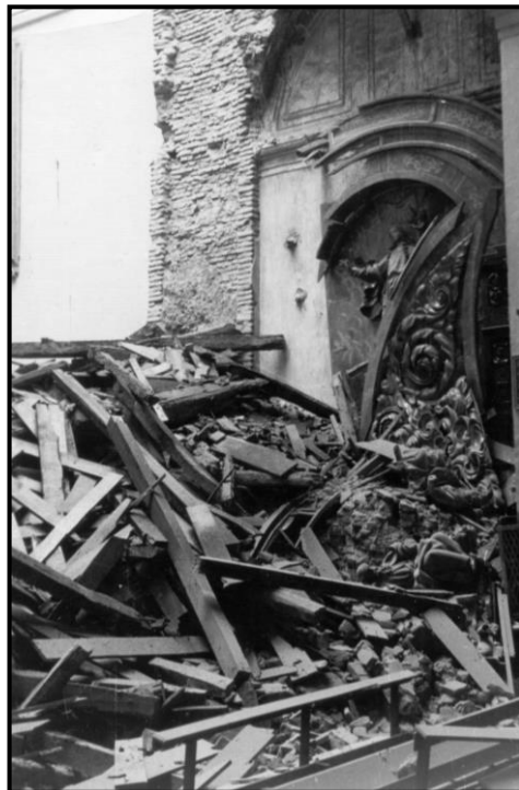
Il. 2- Situación de la Asunción tras el derrumbe del techo de la iglesia.
