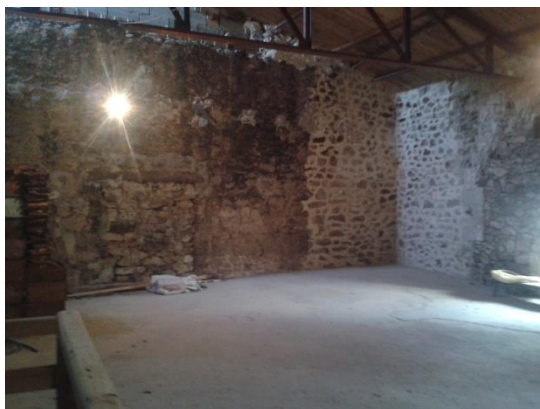
Figura 1: Estado actual de la planta de extracción.
