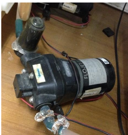
Ilustración 3.9: Bomba Flojet Planta
