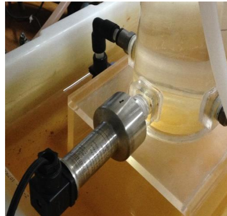
Ilustración 3.4: Sensor de nivel planta
