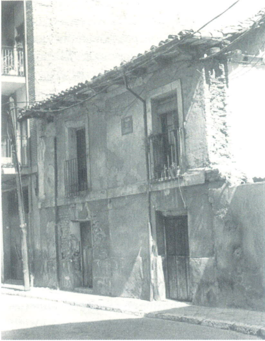
Vivienda semiderruida en la calle Tahonas nº 2 y 4. Un ejemplo del viejo caserío del barrio a punto de desaparecer.
