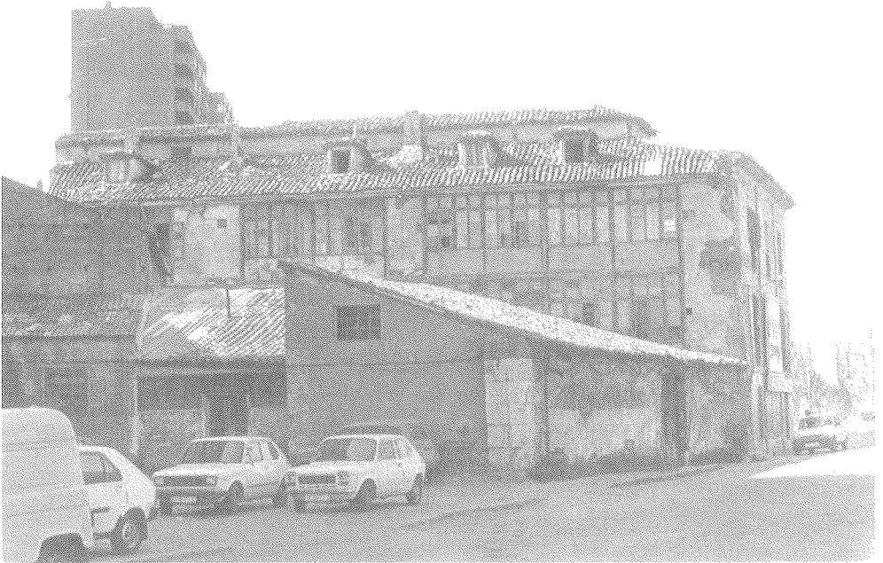
Edificio de la Plaza de San Nicolás nº 9 y 10, visto desde el Paseo del Renacimiento. Un cambio de alineación y la falta de acondicionamiento, acabarán con una construcción de mediados del siglo XIX en uno de los bordes del barrio.
