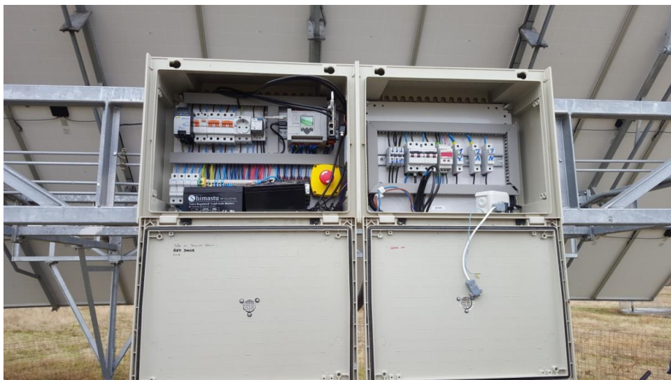
Figura 2.25. Cajas de los seguidores de cabecera de Bercero.
