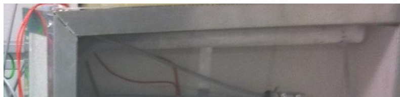
Figura 3.9. Escarcha formada en el evaporador
