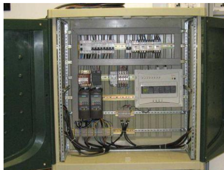
Figura 4.5. Cuadro eléctrico de control de dispositivos.
