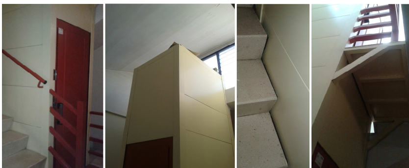
Instalación de ascensor ex novo. Para su colocación se ha aprovechado la escalera del edificio, la cual ha tenido que ser cortada y se han colocado mesetas de acceso. Se encuentra con cerradura para su acceso, su instalación se realizó hace más de 10 años. Urbanización El Príncipe, Real Sitio de San Ildefonso (Segovia). Fotos realizadas el día 7 de abril de 2016.
